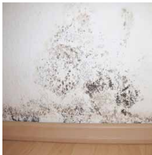
Schimmelbefall in einer Altbauwohnung.
