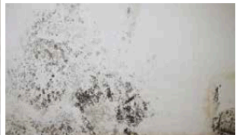
Schimmelbefall in einer Altbauwohnung.
